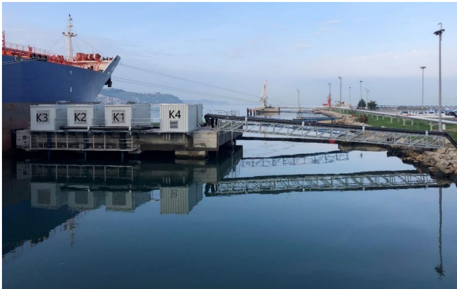
Slika 2: Kontejnerske enote požarnega črpališča TRO
