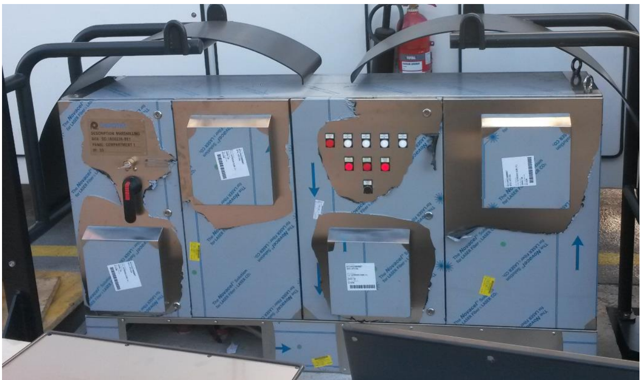
Slika 1: Obstoječa omarica za priklop E-RTG dvigal
